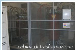
cabina di trasformazione
